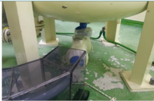
[사진 1] 누출이 발생한 불산탱크 하부 모습
