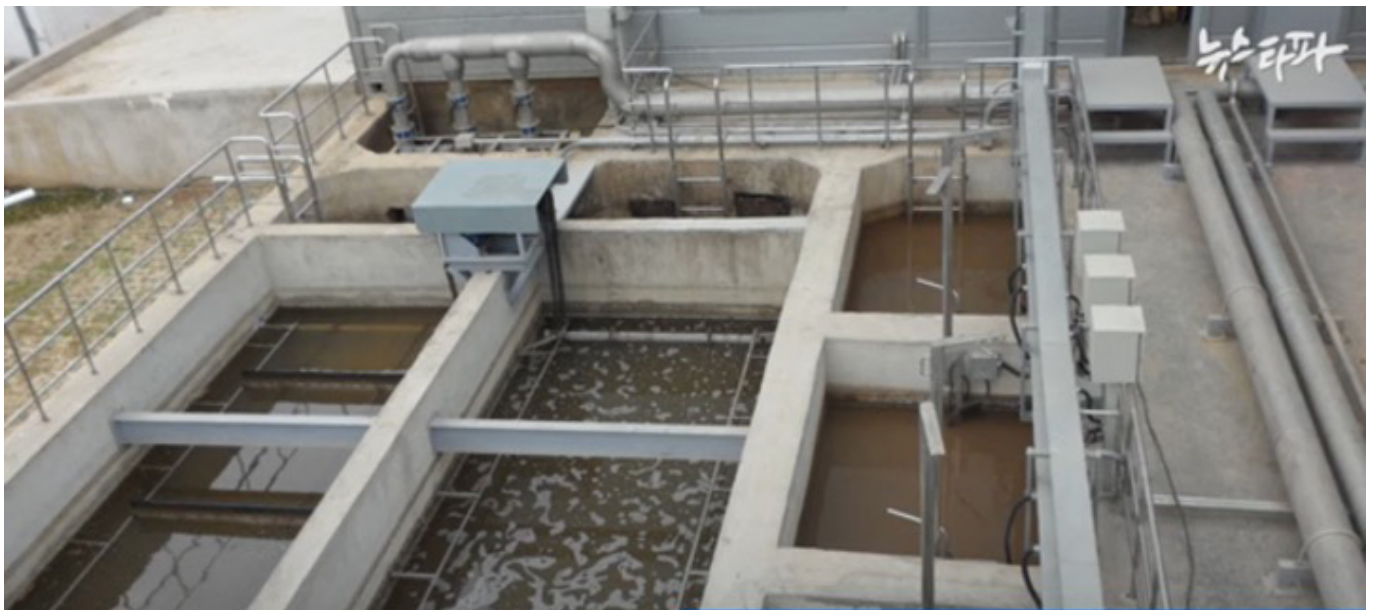
2013년 촬영된 박닌공장 오폐수 처리시설 사진
